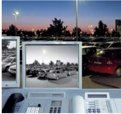
闭路电视 (CCTV) 系统
